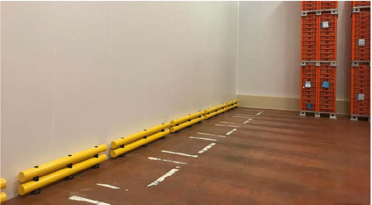
Protection de cloison en zone de stockage frigorifique ▼
